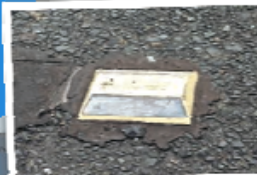
A road stud
